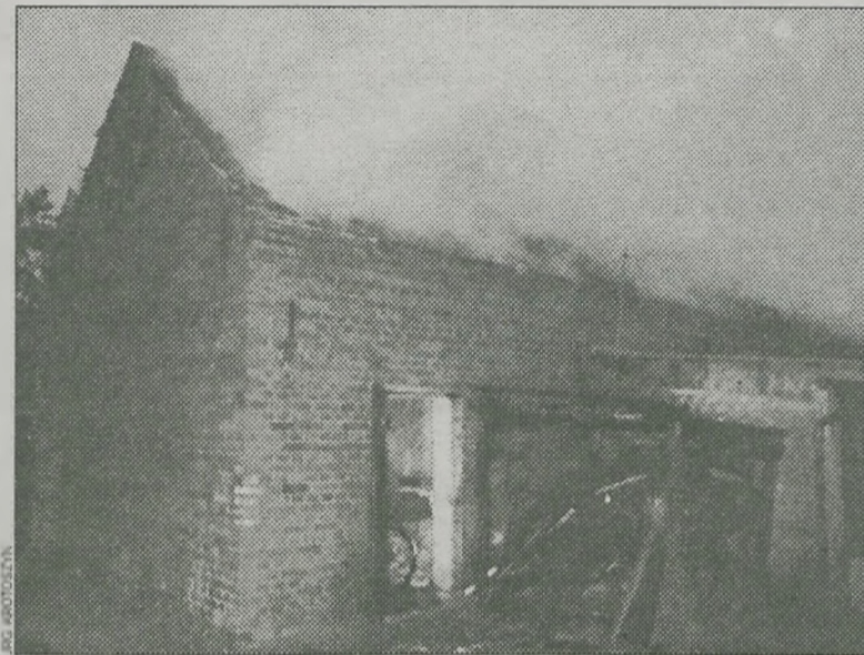
Spłonął dach budynku gospodarczego
