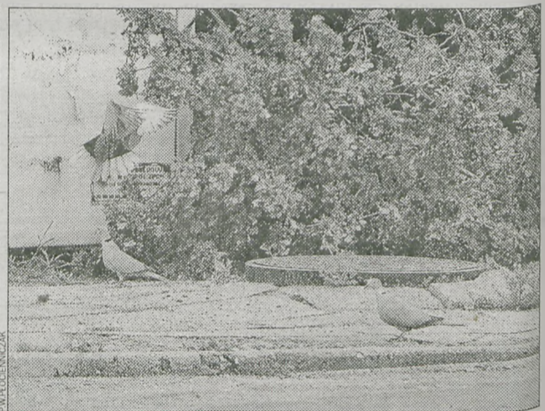
W niektórych miejscach studzienki wystają o kilka centymetrów
