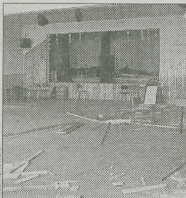
Zniszczona aula czeka na modernizację
