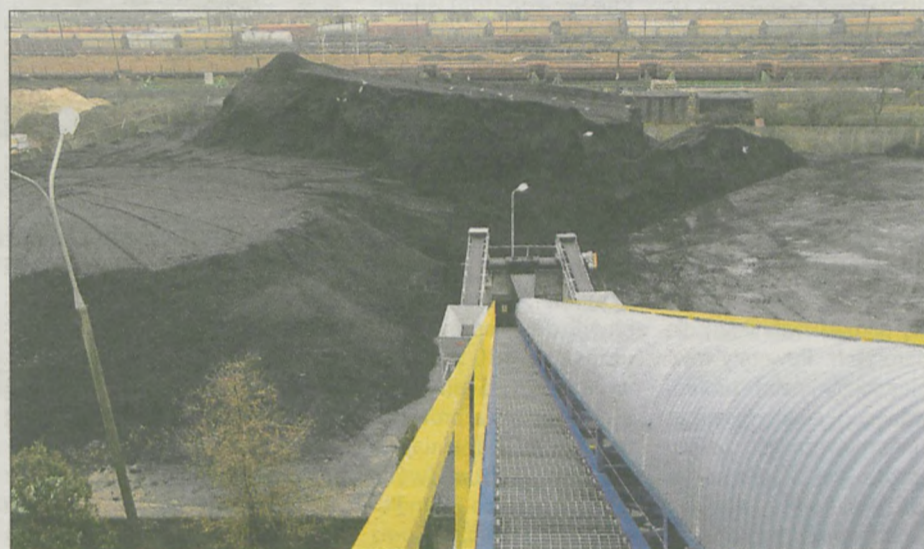
Zmodernizowany został też system podawania węgla do kotłów
