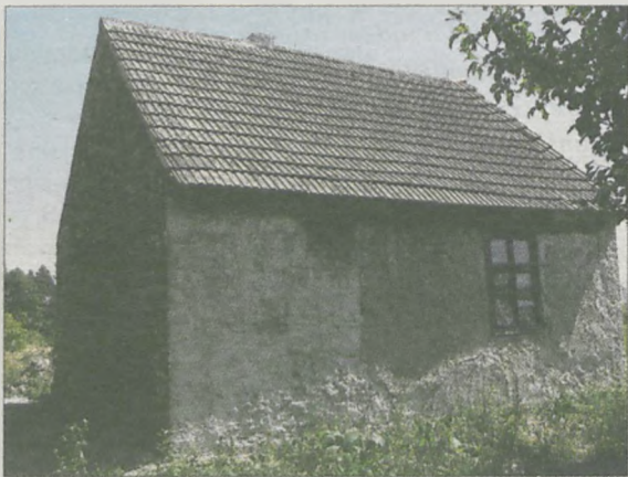
ZE ŚCIANY frontowej zniknęła dziura
