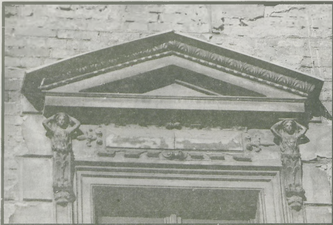
Warto ocalić niewielkie kariatydy na niszczącej fasadzie przy ul. Koźmińskiej
