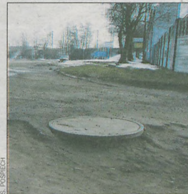
Dziura na ul. Magazynowej
