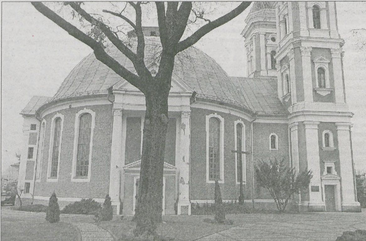
Konstrukcja i dach nadają się do gruntownego remontu
