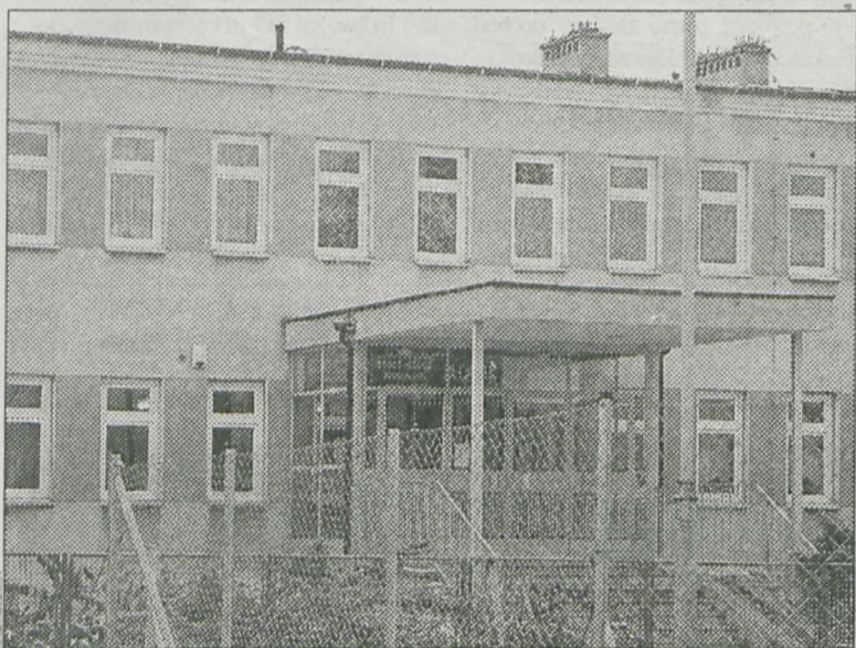
Ten budynek czeka na remont
