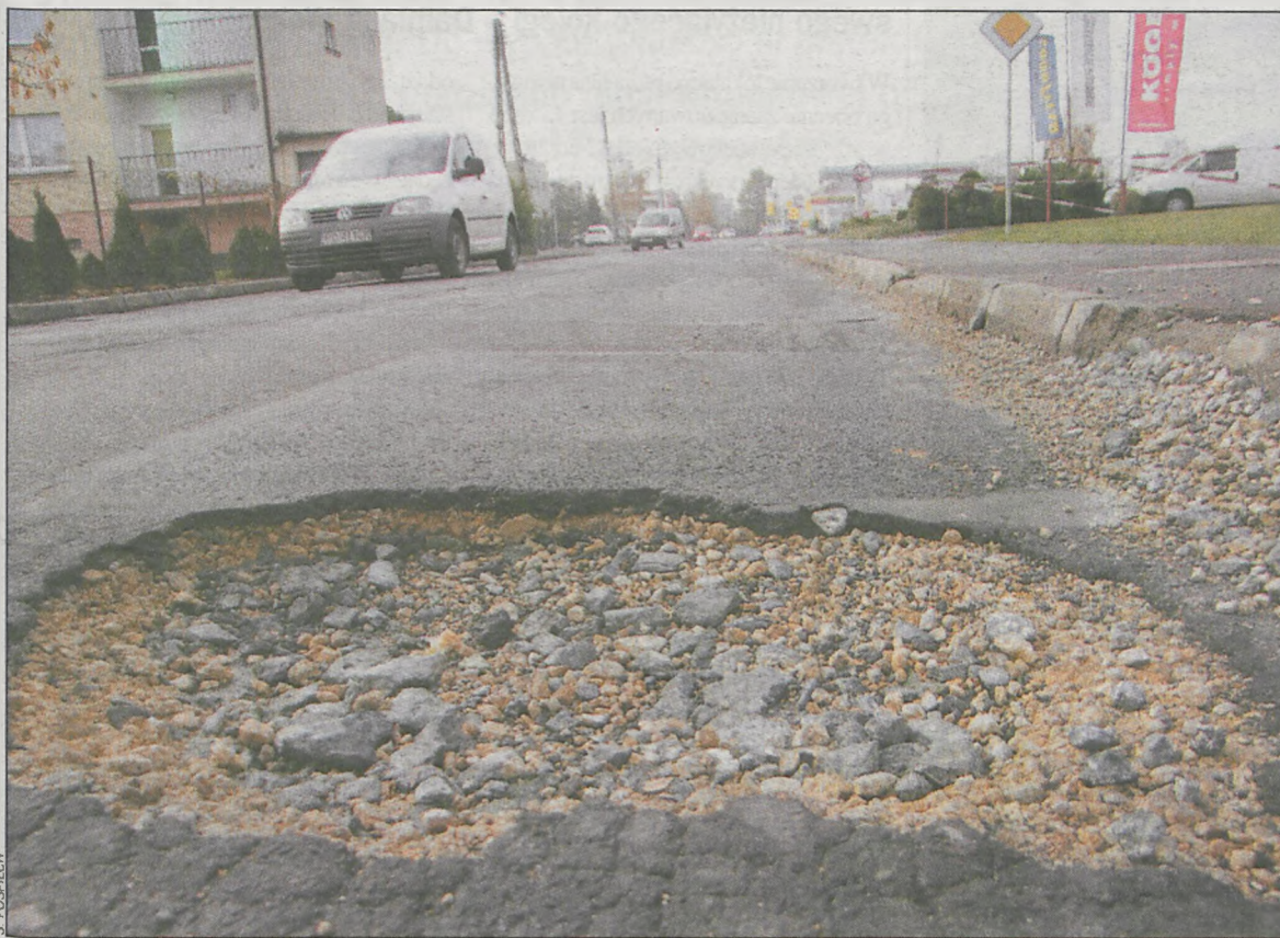
Dziura w drodze gminnej – ul. Tartaczna
