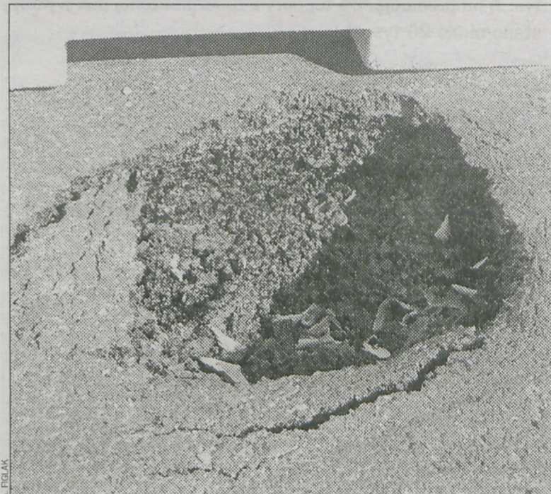
Po naprawie asfalt ponownie zapadł się
