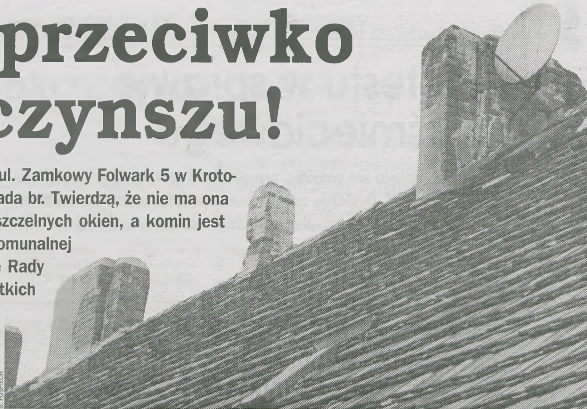
Kominy budynku na Zamkowym Folwarku są w opłakanym stanie
