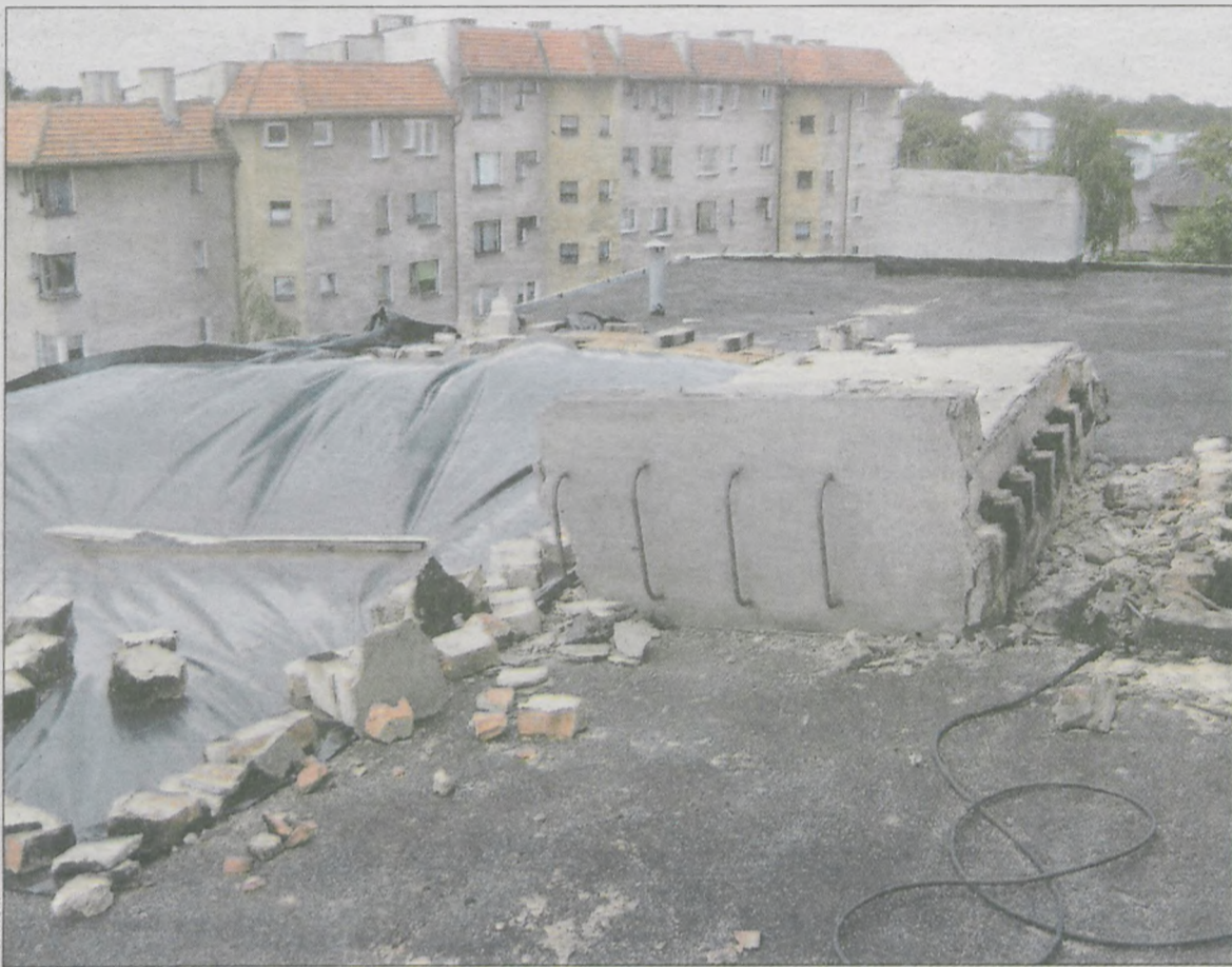
Połowa 3-metrowego kominu pozostała na dachu...
