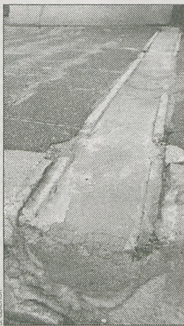
Zalanie krater ściekowych cementem, to wyjątkowa fuszerka
