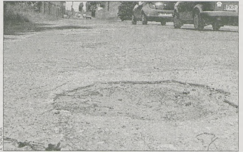
Dziury w jezdni cały czas czekają na naprawę
