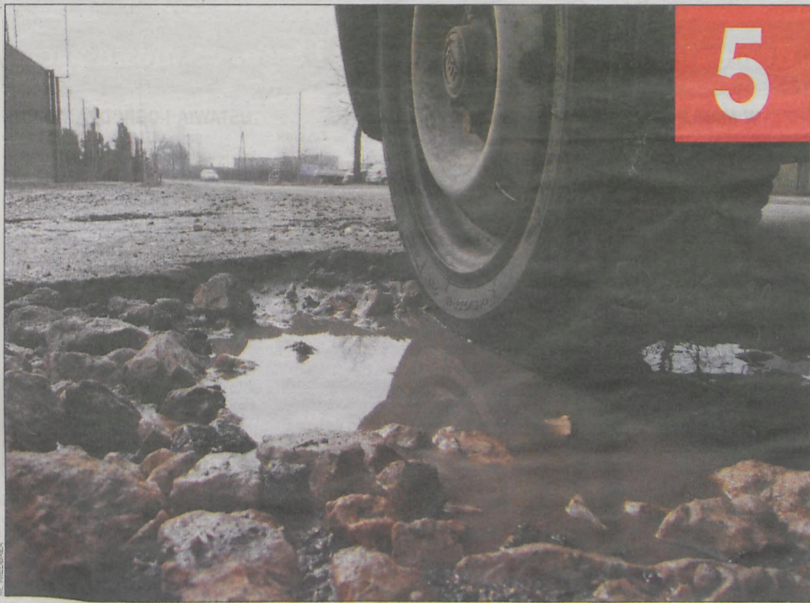
W głębokich wyrwach nietrudno o uszkodzenie zawieszenia
