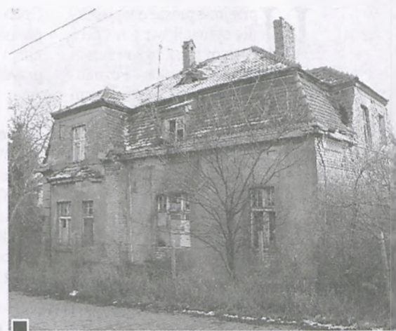
Stary, około stuletni budynek przy ul. Poniatowskiego 8, obecnie pustostan, w którym schronienie znalazło trójka bezdomnych. Jego stan techniczny (m.in. popękane ściany, ubytki cegieł, grożący przewróceniem komin, zarwane schody na piętro, uszkodzone stropy) stanowi ogromne zagrożenie życia i zdrowia ludzi fot. Paweł Wolniewicz
