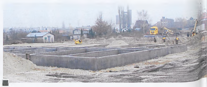
Gotowa betonowa podstawa pierwszego bloku. Widać, że każdy moduł - mieszkanie (pokój) ma własne fundamenty. Widok ze skrzyżowania ul. 3 Maja z ul. Armii Poznań
