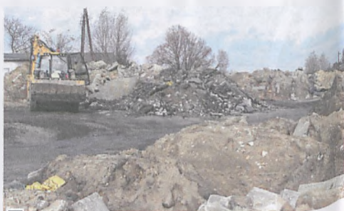
Po budowie obwodnicy zostały do wywiezienia i uporządkowania duże ilości ziemi, betonu, asfaltu, śmieci składowanych przy ul. Krętej w okolicy wiaduktu kolejowego fot. Mariusz Marszałkiewicz
