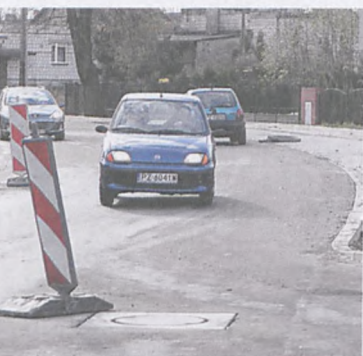
Na początku listopada, pomimo prac wykończeniowych na obwodnicy, ruch samochodowy odbywał się w pełni. Kierowcy siałomem omijały poziomowane w tym czasie studzienki kanalizacyjne fot. Mariusz Marszałkiewicz
