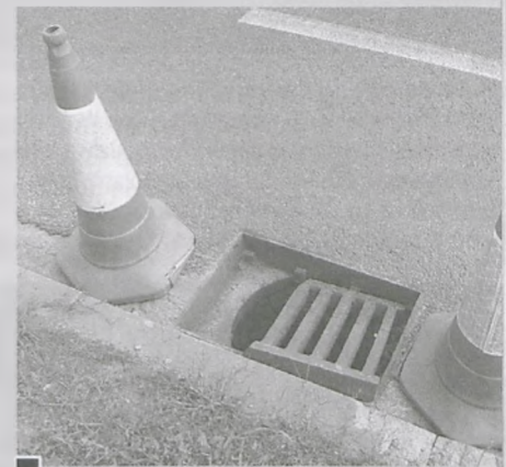
Uszkodzona kratka na ul. Armii Poznań fot. Paweł Wolniewicz
