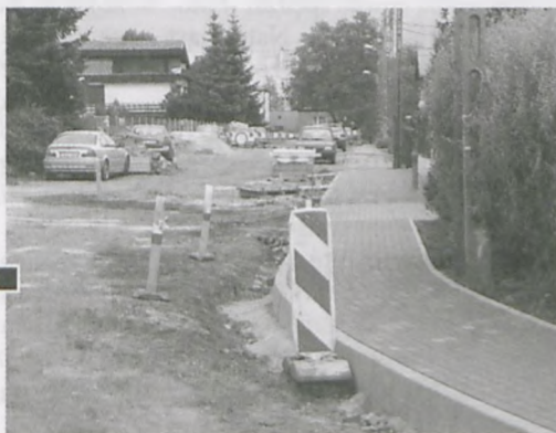
Na ul. Ziemniaczanej wymienia się kanalizację deszczową i trwa układanie chodnika po wschodniej stronie drogi fot. Piotr P. Ruskowski
