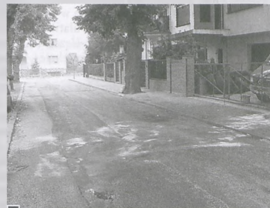
Plama po rozтворze mocznika na jezdni ul. Lipowej
