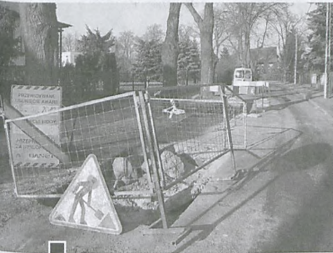
Żeby dostać się do źródła wycieku, zerwano asfalt i wykonano głębokie wykopy w dwóch miejscach ul. Szkolnej fot. Hanna Siatka
