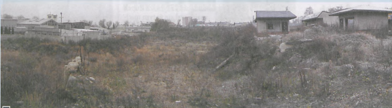
Zarośnięty kilkumetrowej głębokości wykop pod niedoszłą inwestycją. Po prawej – pozostałości po CH Gesa, po lewej zabudowania firmy Steelpress fot. Hanna Siatka
