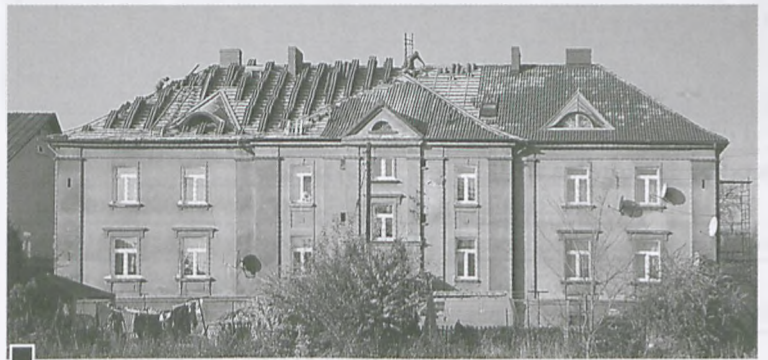
Remont dachu na Domu Gminnym przy ul. Armii Poznań 35 fot. Piotr P. Ruszkowski
