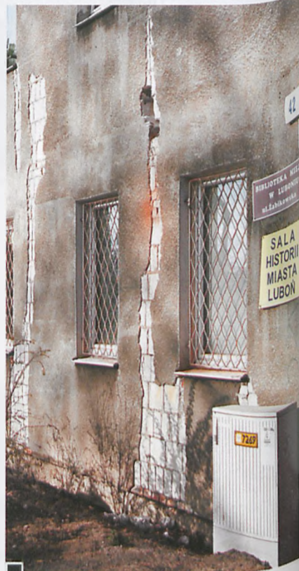
Na zdjęciu widać wadliwy sposób włączania muru. Dziura wykonana w wieńcu na pograniczu pięter potrzebna była do zbadania stanu i jakości stropu fot. Tomasz Chojnacki
