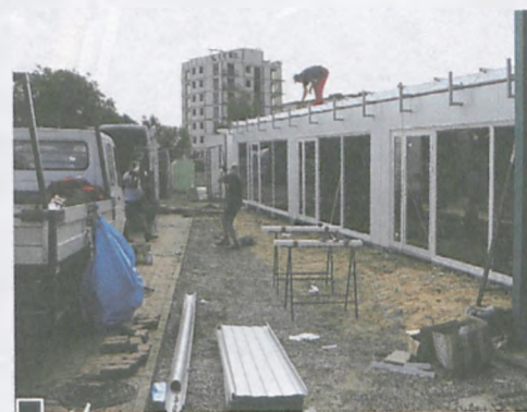
Montowanie pawilonów na terenie A. Szafrana. Zakupów można na razie dokonywać przy wejździe na posesję od strony ul. Żabikowskiej fot. Paweł Wolniewicz
