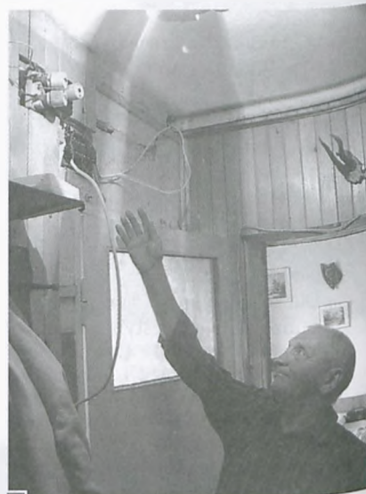
Przy przebudowie instalacji elektrycznej pozostawiono na wierzchu kable z rozebranym i wiszącym prowizorycznie włącznikiem fot. Paweł Wolniewicz
