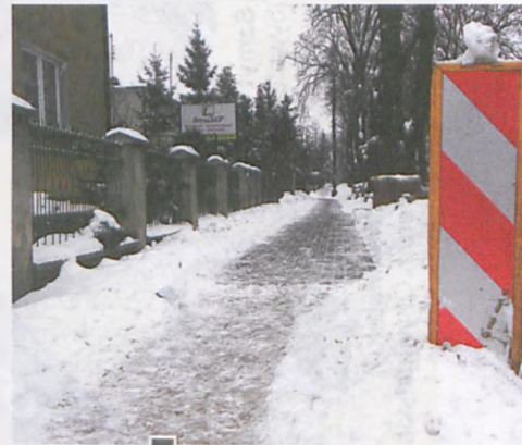
Krótki fragment wyłożonego szarym pozbrukiem nowego chodnika w okolicy ul. Jodłowej. O tym, że roboty wciąż trwają, świadczą zgmagazynowane materiały i oznakowanie fot. Hanna Siatka
