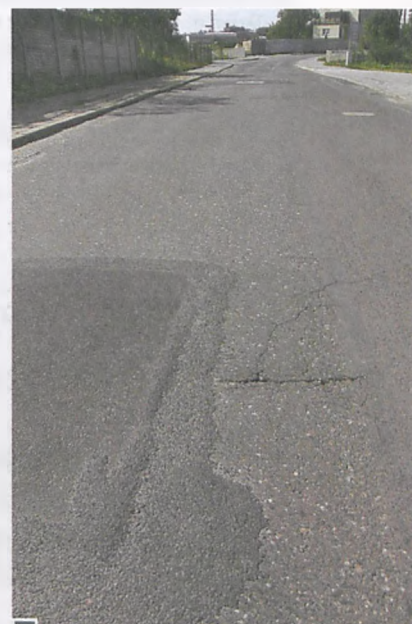
Nowa łata z nieporządnie wykonanym wykończeniem. Tuż obok pęknięcia asfaltu, które pominięto fot. Piotr P. Ruskowski
