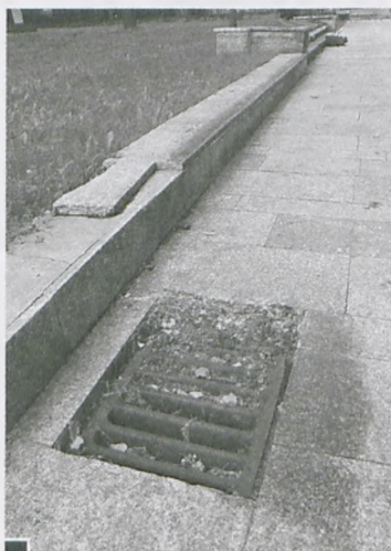
Uprzątnięty teren obozu szpecą ubytki płyt na murkach przy stopniach prowadzących do Ściany Śmierci oraz zapchane liśćmi studzienki kanalizacyjne fot. Hanna Siatka
