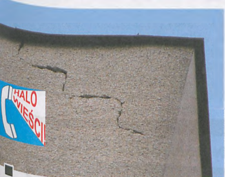
Niebezpieczne pęknięcie muru tuż przy opierzeniu dachu fot. Piotr P. Ruskowski
