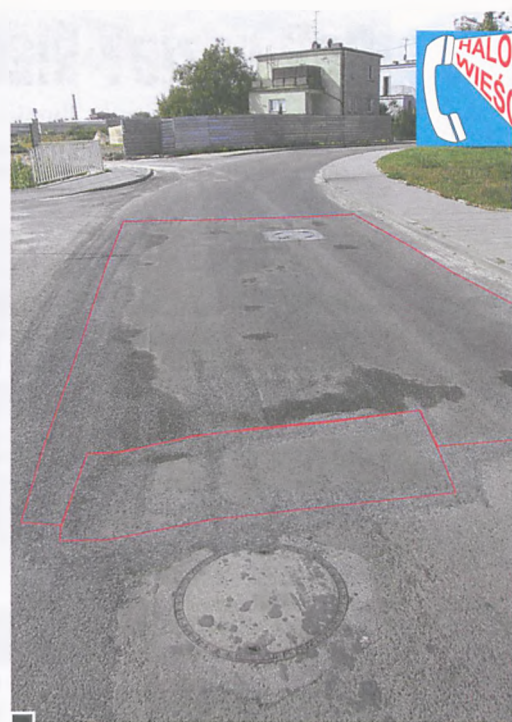
Czerwonym obrysem zaznaczono dwie łaty, nałożone jedna na drugą. Na pochylej powierzchni ul. 3 Maja widać utrzymującą się w warstwie asfaltu wilgoć (ciemne plamy) fot. Piotr P. Ruskowski
