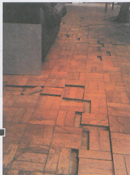
Skutki wody opadowej, która przelała się do jednego z domów przy ul. Konarzewskiego. Zniszczyła całą podłogę fot. Mateusz Pokrywka
