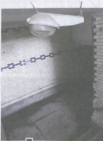
Lampy wewnątrz tunelu są nieczynne fot. Paweł Wolniewicz
