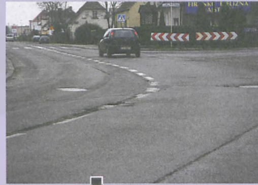
Niebezpieczne pęknięcia nawierzchni na łuku ul. Żabikowskiej i Sobieskiego fot. Paweł Jankowiak
