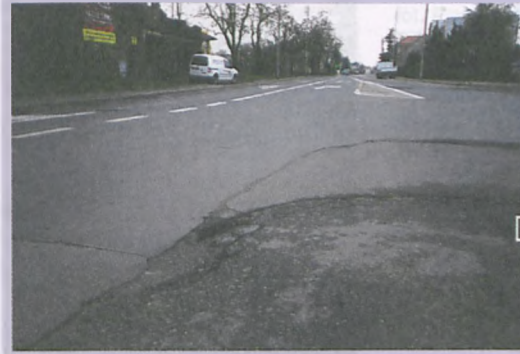
Szczeliny w nawierzchni na ważnym skrzyżowaniu – ul. Żabikowskiej i 11 Listopada fot. Paweł Jankowiak
