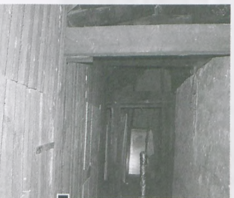
Drewniana konstrukcja strychu w budynku przy ul. Armii Poznań 35 fot. Paweł Wolniewicz
