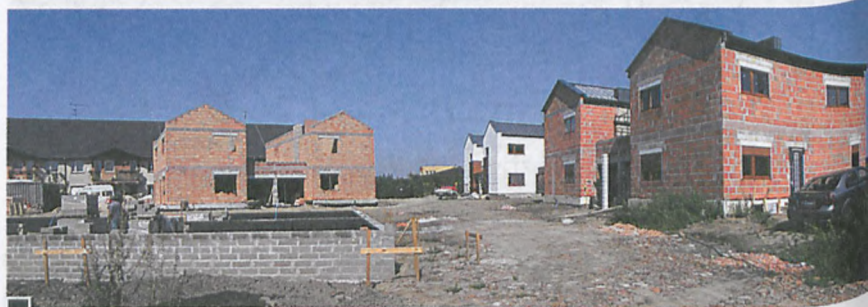
Plac budowy Osiedla Majowego od strony ul. Krańcowej fot. Piotr P. Ruszkowski
