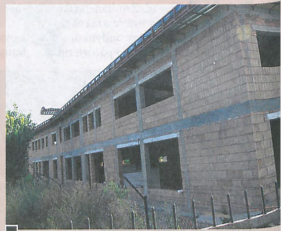
Nowy kompleks handlowo-usługowy przy ul. Wojska Polskiego w budowie fot. Mateusz Pokrywka
