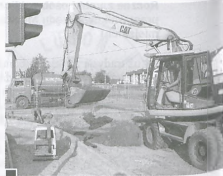
■ Ostatnim etapem robót związanych z modernizacją ul. Fabrycznej (kanalizacja i położenie nowej nawierzchni) było skrzyżowanie tejże drogi z ul. Sobieskiego fot. Paweł Woźniak
