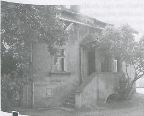
Widok zaniedbanego budynku o pięknej architekturze przy ul. Okrzei 67 fot. Paweł Wolniewicz
