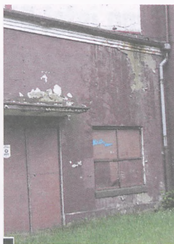
Prześiąknięte wilgocią ściany porzuczonego przez miasto budynku dawnego kina przy ul. Armii Poznań, z pewnością zagrzybione, może już nadają się jedynie pod spychacz fot. Piotr P. Ruzzkowski
