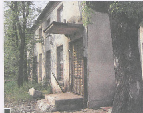
Budynek Ośrodka Kultury przy ul. Armii Poznań, widok od tyłu. Gmach graniczy bezpośrednio z prywatną posesją, na teren której wychodzą: okna, wyjście ewakuacyjne, rynny itd. Za tak bezsensowne, niezgodne z przepisami budowlanymi oraz zasadami bezpieczeństwa, skomunalizowanie mienia po Zakładach Ziemiannych ktoś w Urzędzie Miasta jest odpowiedzialny fot. Katarzyna Frąckowiak
