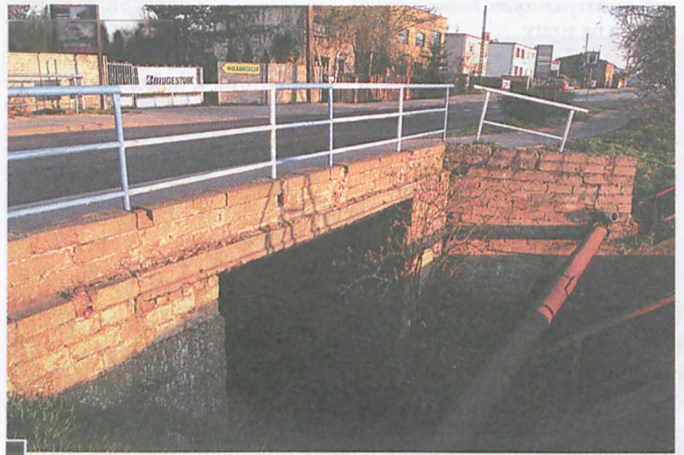
Mostek nad Strumieniem Junikowskim na ul. Żabikowskiej (przy rondzie). Widoczne wyraźne spękania i rozstępy w budowlach. Niebezpieczne odstępy między barierkami fot. Michał Głazik
