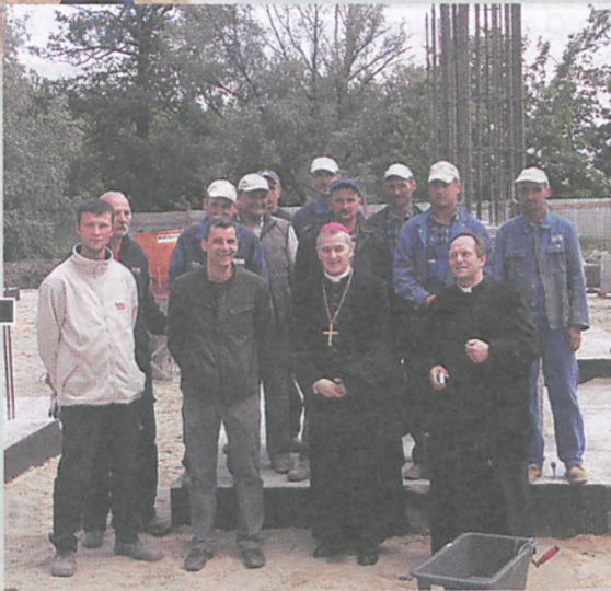
Pamiętkowe zdjęcie ekipy budowlanej z bp. G. Balcerkiem. Po jego prawej stronie – szef lubońskiej firmy Budoforma stawiającej bryłę świątyni – Szymon Bielawski. Z lewej strony Gościa – gospodarz parafii pw. św. Barbary – ks. prob. Bernard Cegła fot. Grażyna Konieczna
