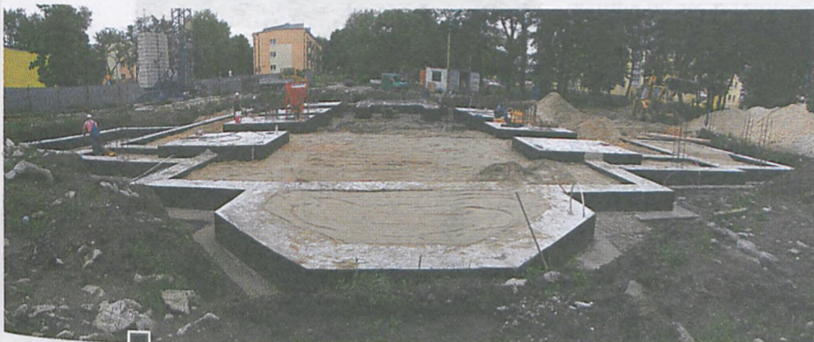
Widać już zarys bryły świątyni. Na pierwszym planie fundamenty pod przyszłe prezbiterium (widok od strony Strumienia Junikowskiego) fot. Piotr P. Ruskowski
