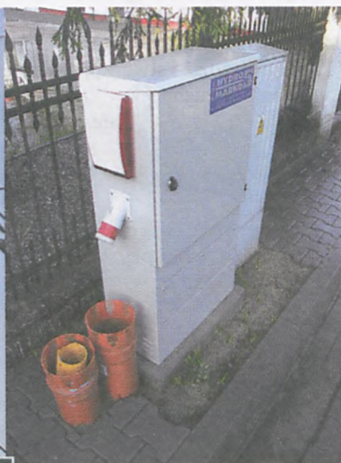
Rozdzielnia prądu dla przepompowni i nie podłączone do zasilania, zwisające (ukryte w słupie) kable energetyczne fot. Piotr P. Ruszkowski
