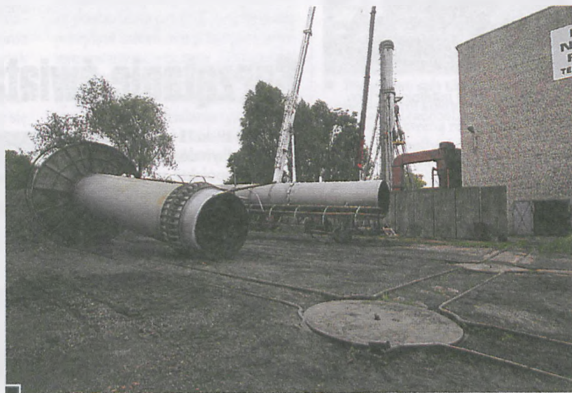
■ Zdemontowane zużyte fragmenty starego komina. Na pierwszym planie obrotnica i tory, po których do wnętrza kotłowni transportowany jest za pomocą wózków miał węglowy, będący podstawowym paliwem w procesie grzewczym fot. Przemysław Maćkowiak
