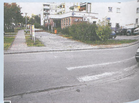
Ledwo widoczne pasy na ul. Sikorskiego przy banku fot. Paweł Jankowiak
