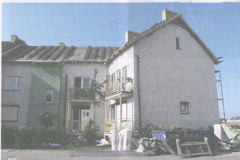
Widok spalonego segmentu bloku przy ul. Niezłomnych 31 w ostatnich dniach września. Na pokrytych papą dachach – gotowe do ułożenia dachówki, wewnątrz jeszcze pracowały ekipy remontowe fot. Hanna Siatka
