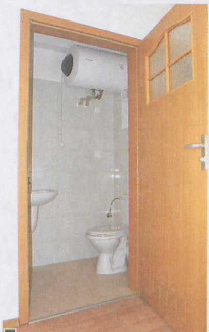
Niewielka, taka sama w każdym mieszkaniu łazienka – sedes, umywalka, zbiornik na wodę, kabina prysznicowa (niewidoczna na zdjęciu – z lewej) fot. Hanna Siatka
