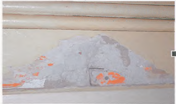
Odpadające tynki wewnątrz budynku Pogotowia Ratunkowego fot. Kamila Pruszk-Posłuszny
