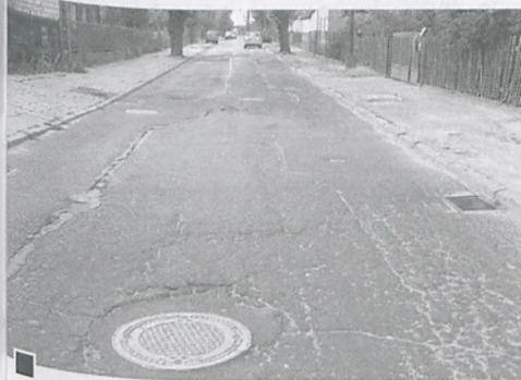
Przewidziana do załatania ul. Cmentarna – wąska, ruchliwa i w fatalnym stanie. W związku z tym, że prowadzi do węzła autostrady A-2 i drogi na Wrocław, panuje tu uciążliwy dla mieszkańców, wzmożony ruch, również samochodów ciężkich, które niszczą i tak już kiepską nawierzchnię. Sytuację poprawiłaby z pewnością zmiana organizacji jazdy w tym miejscu – zamknięcie ul. Cmentarnej dla samochodów wjeżdżających z ul. Poniatowskiego. Podobnie jak to ma miejsce każdego roku w dniu 1 listopada, ruch odbywałby się wówczas w jednym kierunku: ulicą Traugutta i Cmentarną – do ul. Poniatowskiego fot. Hanna Siatka
