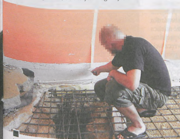
Naprawiając swój błąd budowlany, wykonawca zastosował zbrojenie, którego wcześniej nie było oraz specjalne żelbetonowe słupy pionowe (tzw. szklanki) fot. Hanna Słatka
