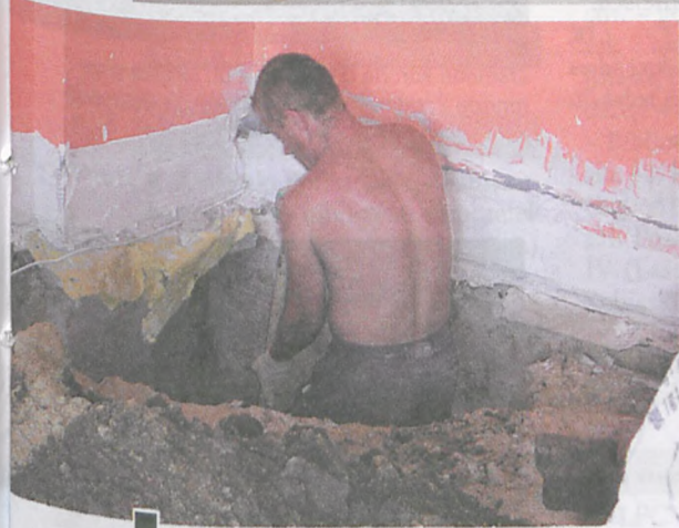
Po zdjęciu betonu posadzkowego ukazały się jamy w gruncie, do których mógł wejść człowiek
