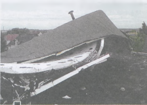
Wiatr wyrwał przy okazji instalację odgromową i kominki wentylacyjne fot. Michał Drzewiecki
