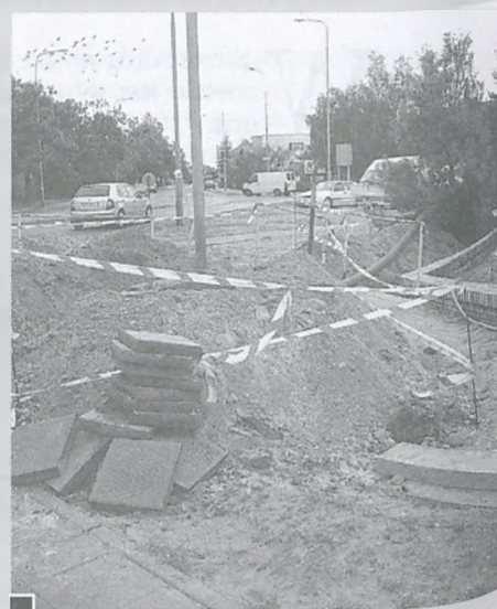
Przez skrzyżowanie ul. Żabikowskiej z Kościuszką Aquanet przeprowadził w połowie lipca wodociąg do nowych bloków przy ul. Wschodniej fot. Mateusz Pokrywka
