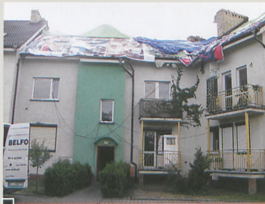
Prowizoryczne zabezpieczenie spalonego dachu foliami i plandekami fot Katarzyna Frąckowiak
