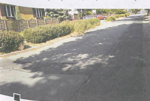
Przykład wadliwie wykonanej nawierzchni po podłączeniach – ul. Wojska Polskiego fot. Mateusz Pokrywka
