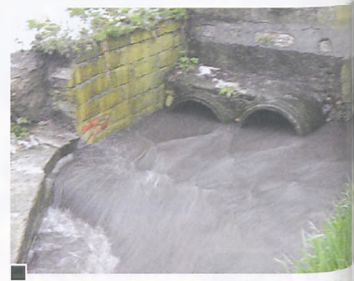
Za przepustem (wlot ul. Sikorskiego) przepływ wody odbywał się sprawnie fot. Hanna Siatka
