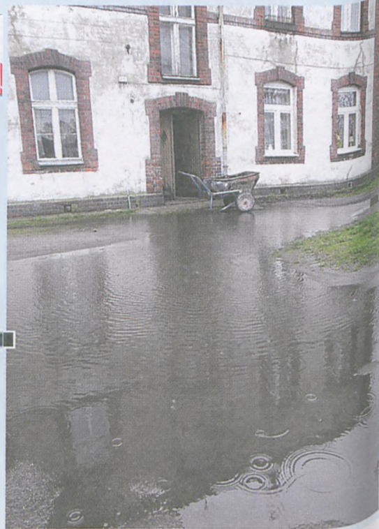
Po większych deszczach podwórze domu komunalnego przy ul. Armii Poznań 66 zalewane jest do tego stopnia, że lokatorzy nie mogą przedostać się do ubikacji i pomieszczeń gospodarczych po drugiej stronie. Zdjęcie wykonano po deszczu, na kilka dni przed nawałnicą 15 kwietnia fot. Piotr P. Ruszkowski
