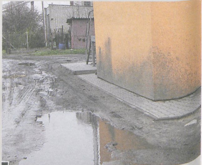
Ochlapaną błotem szczytowa ściana pocegielnianego budynku komunalnego fot. Hanna Siatka
