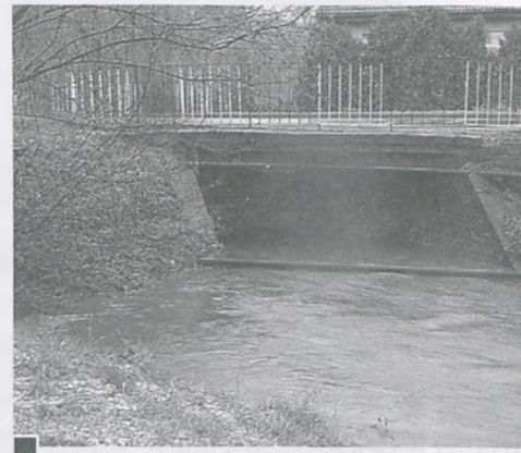
Przepust pod ul. Armii Poznań – zalany w 100%, spiętrza wodę przed wlotem fot. Tadeusz Urban
