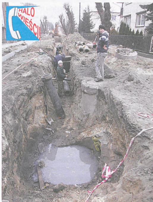
Ścieki bytowe z deszczówki ul. Jagiełły zalały budowę w ul. Konopnickiej fot. Piotr P. Ruszkowski
