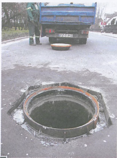
Wymieniony i poprawnie omurowany przez służby miejskie wąż studzienki kanalizacyjnej fot. Piotr P. Ruskowski
