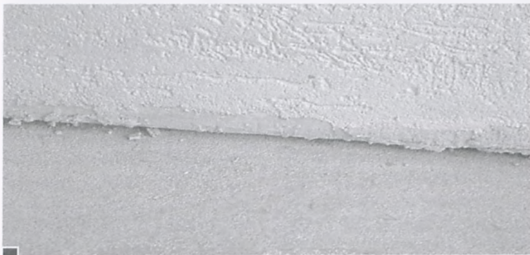
Wyraźny odstęp między ścianą i podłogą wskazujący na osiadanie budynku fot. Hanna Siatka
