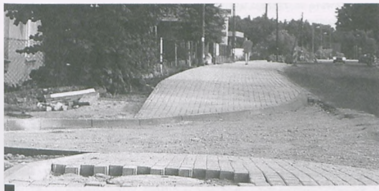
Szerokie chodniki, nachylone stromo do bocznych uliczek, szczególnie zimą mogą być niebezpieczne. Podniesiona nawierzchnia ul. Armii Poznań powodować będzie spływanie wód deszczowych w nieutwardzone ulice, które już mają problemy z odwodnieniem fot. Katarzyna Frąckowiak
