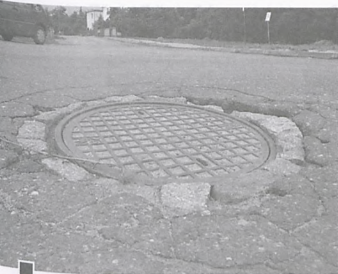
Tiry zrujnowały niektóre studzienki kanalizacyjne i asfalt wokół nich. Na zdjęciu przykład u wylotu ul. Lemańskiego. fot. Piotr P. Ruskowski
