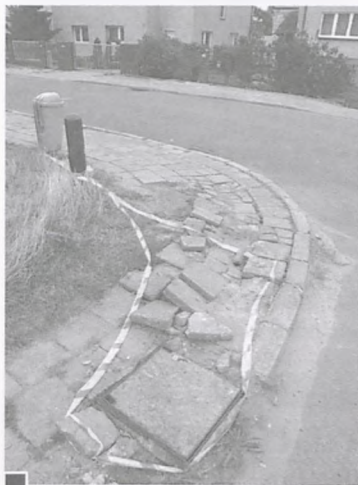
Zdewastowany chodnik przy wjeździe z ul. 3 Maja w Cichą fot. Piotr P. Ruskowski
