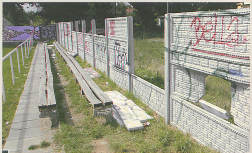
Wyłamano 19 płyt betonowych z ogrodzenia boiska Stelli fot. Paweł Jankowiak
