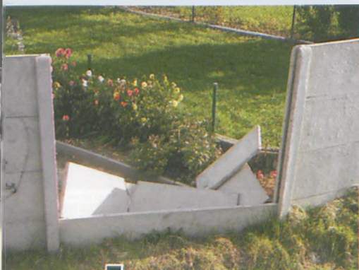
Zniszczony płot ROD „Bratek” fot. Jan Błaszczak
