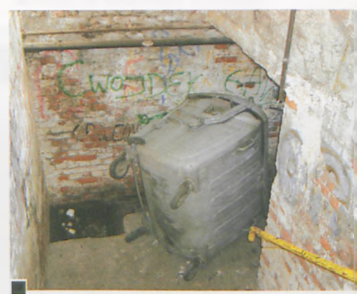
Kontener na śmieci w tunelu ul. Armii Poznań fot. Maciej Szymczak
