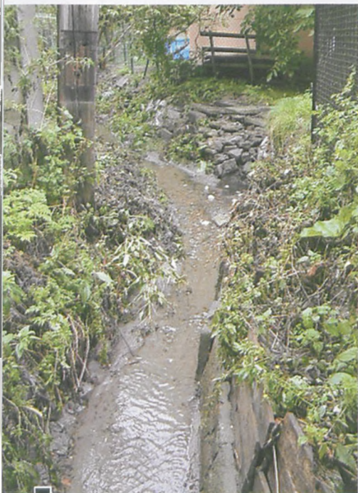
Mieszkańcy na własną rękę umacniają wąskie koryto ciek. Wezbrana woda wyrwa te umocnienia, wymywa grunt, kamienie, podmurówki płotów i wszystko co znajduje się na drodze nurtu, na zagospodarowanych do maksimum brzegach fot. Hanna Siatka
