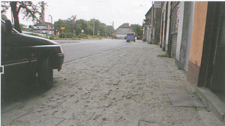
Nierówna, chropowata powierzchnia chodnika na ul. Dworcowej fot. Paweł Jankowiak
