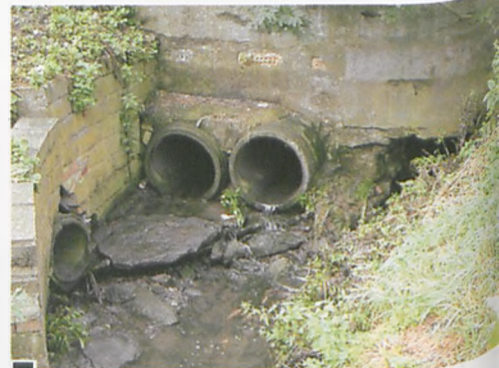
Ujęcie przepustu pod ulicą Kościuszki (przy parkingu od ul. Sikorskiego). Rury mają przekrój zaledwie 40cm (zdaniem Tadeusza Gierczyka z Wydziału Ochrony Środowiska – wystarczający). Z prawej widoczny stary przepust, dziś płynie nim deszczówka fot. Hanna Siatka
