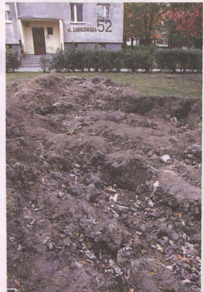
Niebezpieczne wykopki po remoncie przed blokiem nr 52 fot. Piotr P. Ruskowski
