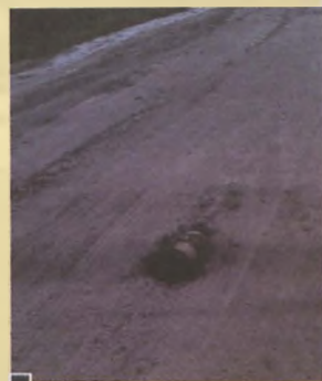
Wyrwana podczas równania drogi przykrywa zasuw wodociągu fot. Andrzej Kierzyńka
