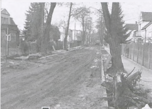
Przygotowując ul. Matejki do utworzenia położono obustronnie wąskie chodniki i wyrudowano kilka drzew fot. Piotr P. Ruskowski
