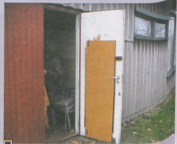
Zniszczone drzwi od świetlicy fot. Jan Błaszczak
