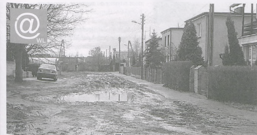
Fragment ul. Miodowej (boczna od Morelowej) 3 grudnia. Pomimo wypompowania (zapewne przez służby miejskie) większości stojącej tu wcześniej wody stan drogi jest opłakany. Mieszkańcy i samochody grzęzną w błocie fot. Janusz Król
