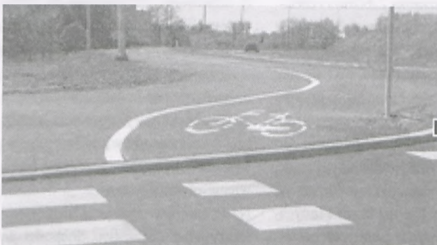
Krawężniki przy przejściach na łączniku wyższe niż zalecane normy przewidziane dla likwidacji barier architektonicznych fot. Hanna Siatka
