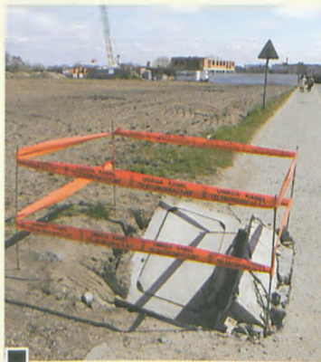
Kolejny raz zniszczono studzienkę telekomunikacyjną na ul. Pułaskiego fot. Piotr P. Ruszkowski
