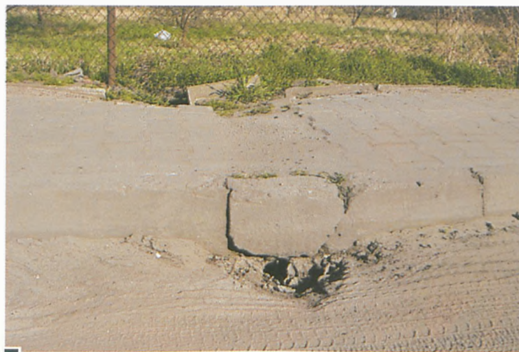
Do odprowadzenia wody z ulicy wkopano pod chodnikiem rurę, skutkiem czego zapadł się krawężnik i chodnik fot. Magdalena Woźniak-Patej
