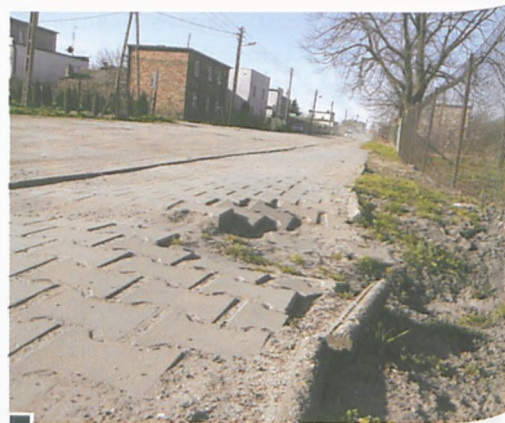
Zniszczony pozbrukany chodnik na ul. Poznańskiej fot. Magdalena Woźniak-Patej
