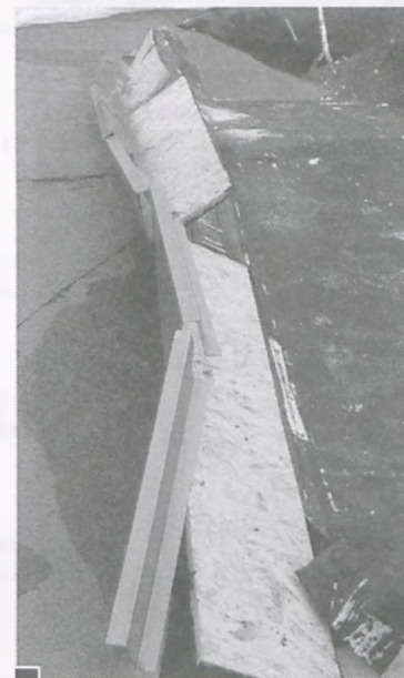
Fragment zerwanego przez wicher pateracko wykonanego opierzenia
