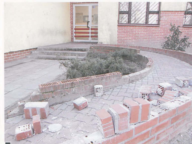
Oficjalne wejście do Poradni Psychologiczno – Pedagogicznej mieszczącej się w budynku Szkoły Podstawowej nr 2 (od strony drogi osiedlowej). Zdewastowane murki odgradzające wjazd dla wózków fot. Piotr P. Ruszkowski
