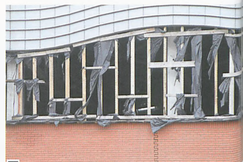
Widziany z dołu dach sprawia wrażenie masywnego, nie do poderwania przez wiatr. Poniżej – poszarpana folia – to miejsce, gdzie w ub. roku miały być okna. Biuro Majątku Komunalnego dokonało odbioru technicznego stanu surowego hali w grudniu ub. roku fot. Hanna Siatka
