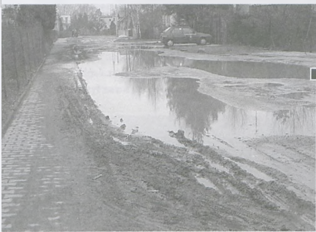
Jadąc dalej ul. Kurowskiego, wcale nie jest lepiej – ogromne kałuże wlewające się na zniszczony kołami chodnik fot. Paweł Jankowiak
