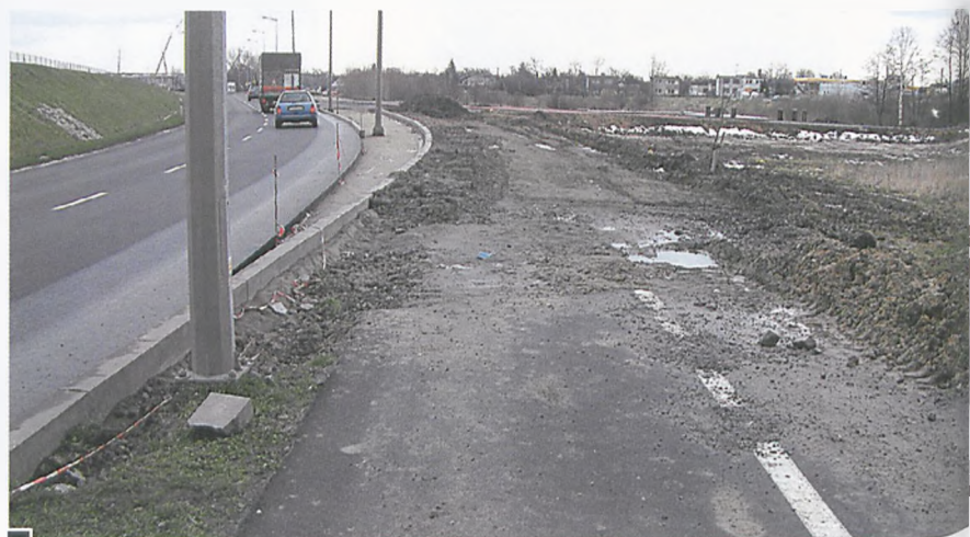
Przerwany ciąg pieszo-rowerowy wzdłuż ul. Unijnej fot. Hanna Siatka
