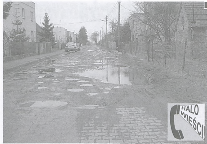
Ul. Migali w Żabikowie – błoto praktycznie przez cały rok (z wyjątkiem upałów). Przed wyborami wyrównano dokuczliwe dziury, ale po tym dziś już nie ma śladu. Mieszkańcy zwracają uwagę na niebezpieczny dla samochodów uskok u wylotu drogi w utwardzoną ul. Poprzeczną. Podobne uwagi co do stanu drogi oraz połączenia z ulicą Poprzeczną dotyczą sąsiedniej ul. Długiej. (H)
