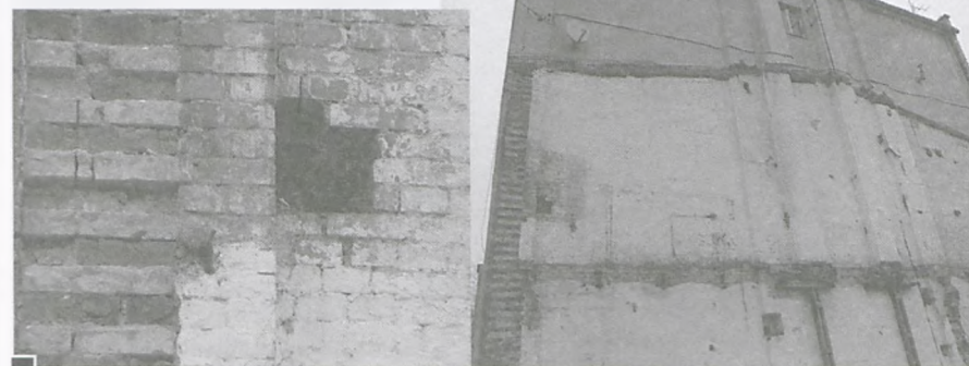
Południowa ściana budynku po rozebraniu krochmalni. Nad stropem pierwszej kondygnacji widoczne wyraźne ślady zagrybienia. Poza tym w ścianie odkryte zostały dziury po likwidacji instalacji, stropów itp. fot. Piotr P. Ruskowski
