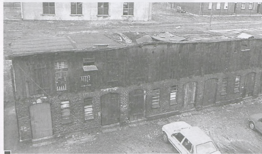
Zapadnięte dachy przydomowych komórek powodują dalszą dewastację fot. Piotr P. Ruskowski
