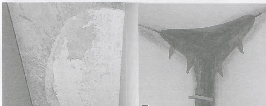
Przykłady zapleśniałych i zagrybionych ścian z różnych mieszkań. Skutki zanieczyszczeń spółdzielni mieszkańcy próbują maskować ozdobnym malowidłem fot. Piotr P. Ruskowski
