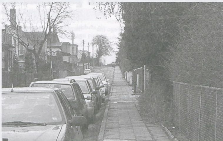
Zarośnięty chodnik z przeszkodami fot. Paweł Jankowiak
