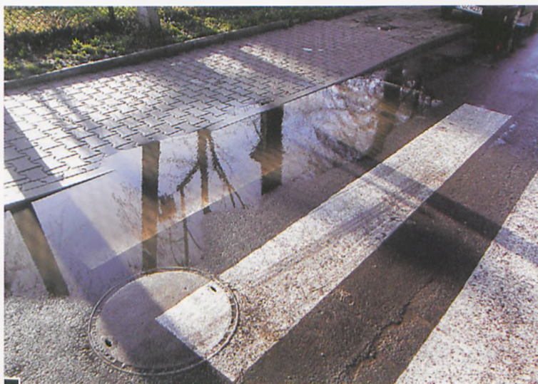
Przykład wadliwie wykonanej inwestycji – przejście dla pieszych na ul. Kościelnej (droga do kościoła pw. św. Jana Bosko) z olbrzymimi kałużami na pasach fot. Piotr P. Ruskowski
