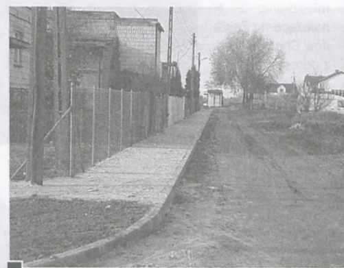
Tuż przed końcem mijającej kadencji Rady Miasta zabrano się za budowę chodnika na ulicy Górnej fot. Magdalena Woźniak-Patej
