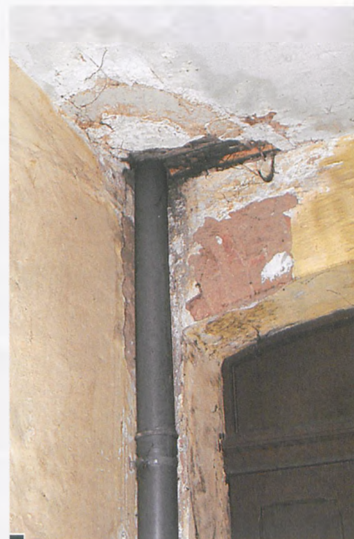
Zacieki i pęknięcia na klatce schodowej - fot. Paweł Jankowiak
