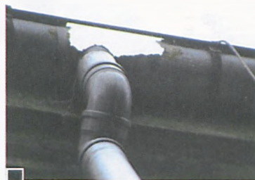
Podziurawione ryny powodują zacieki na murze i wilgoć - fot. Paweł Jankowiak
