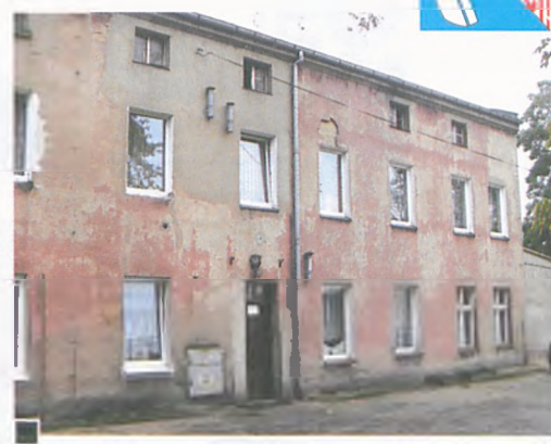
Budynek z zewnątrz - widoczne liczne zniszczenia - fot. Paweł Jankowiak
