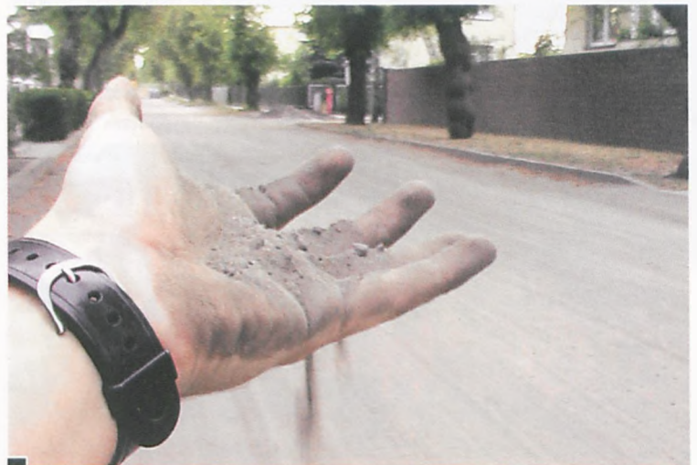
Po niedawnych pracach kanalizacyjnych nawierzchnia pokryta jest wysuszoną, rozjeżdżoną przez auta gliną (pyłem) fot. Andrzej Łuka
