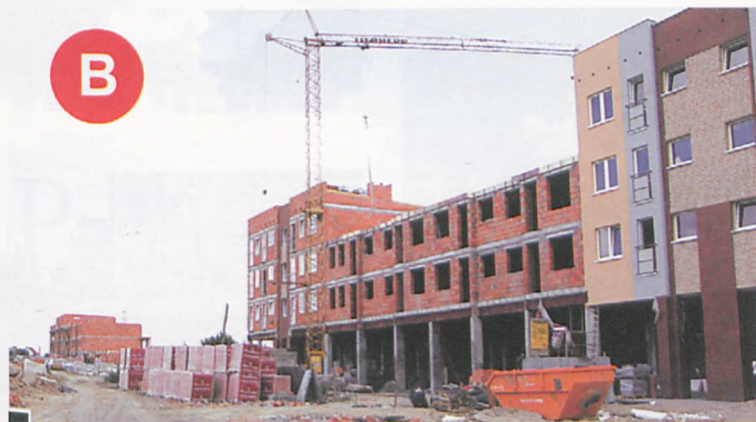
Powstają też bloki przy nowej lubońskiej ulicy – alei Jana Pawła II. Na pierwszym planie budowa drugiego segmentu bloku BUDOFORMY, w głębi bryła powstającego od ul. Pułaskiego bloku firmy KOS-DOM (patrz mapka i zdjęcie – B) fot. Piotr Paweł Ruszkowski
