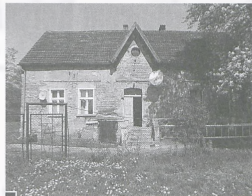
Dwór w Żabikowie – dom wódarza folwarku znajduje się w parku przy ul. Puszkina (stan obecny). Budynek jest własnością miasta, znajdują się w nim dwa mieszkania komunalne. Oprócz prądu i zimnej wody obiekt nie posiada łazienki i ubikacji, ogrzewany jest piecami węglowymi. Budynek nadaje się do kapitalnego remontu i może być sprzedany przez miasto fot. Piotr P. Ruskowski
