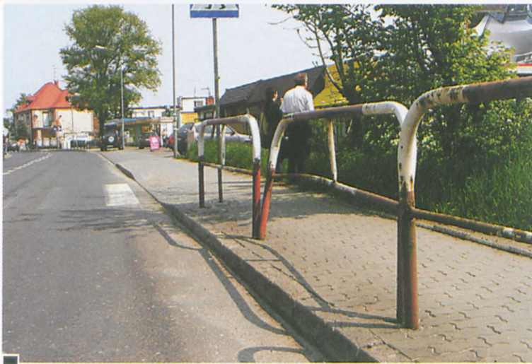
Zardzewiałe i wygięte barierki przy głównej drodze w Luboniu – ul. Żabikowskiej (W) fot. Paweł Jankowiak
