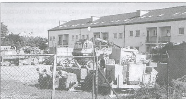
Uciążliwa baza transportowo-budowlana pod oknami
