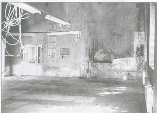
Pożar nowej hali produkcyjnej firmy „Sobolewski Haft” przy pl. E. Bojanowskiego (działała od stycznia br.) spowodował prawdopodobnie uszkodzenie w instalacji elektrycznej. Ogień wybuchł w świąteczny poniedziałek 15 sierpnia. Gasiło go kilka jednostek straży pożarnej. Na szczęście nie ucierpiały nowoczesne maszyny, które po pożarze przeniesiono do starych pomieszczeń. Na zdjęciu – hala w kilka dni po zająciu.
