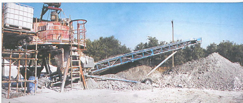
Urządzenia firmy Segal do przeróbki szkodliwych dla środowiska ługów na segalit na terenie Zakładów Chemicznych
