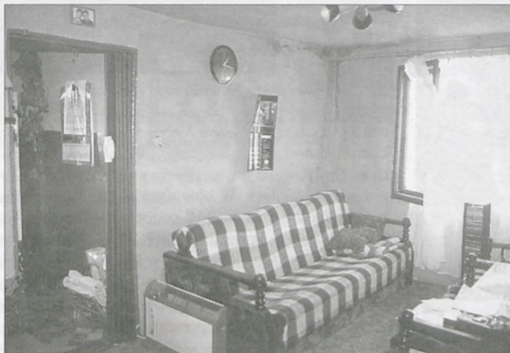
Zagrzybione ściany 12 m 2 mieszkania na strychu dla 5 osób
