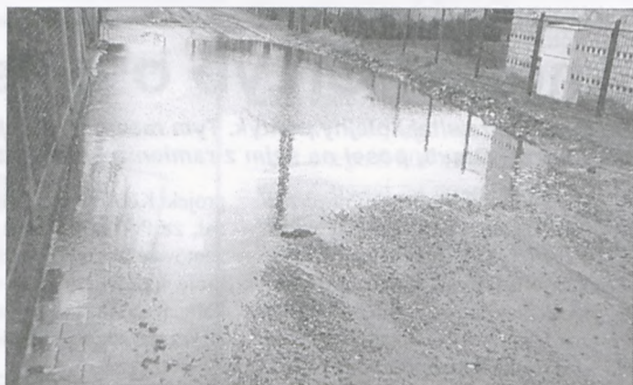
Pomimo odwodnienia ulicy, chodnik, po lewej stronie drogi, całkowicie zalany; po prawej usypany przez mieszkańców nasyp jako przejście.
