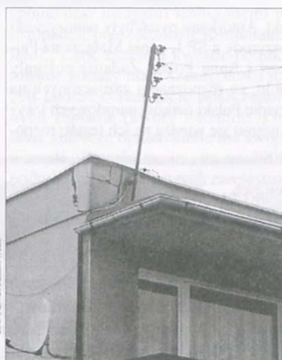
Zniszczenie słupa energetycznego spowodowało wyrwanie fragmentu muru wraz z przyłączem energetycznym posesji leżącej naprzeciwko
